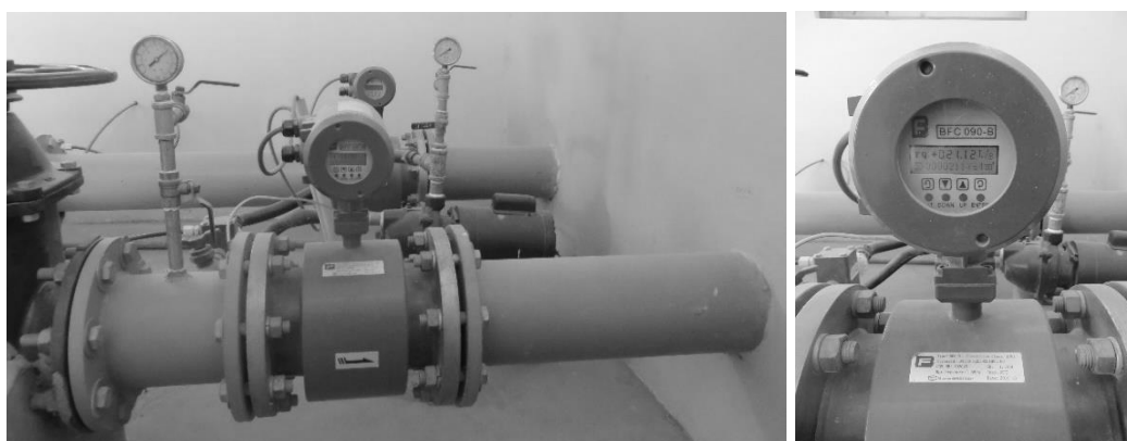
Imagen N° 5 Medidor tipo Electromagnético
